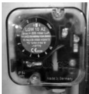
图2-6 负压开关位于电气箱内
